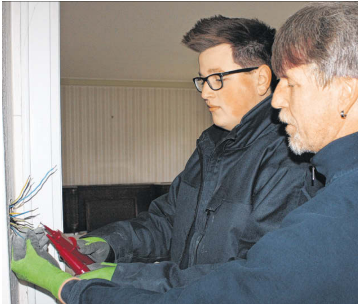
Bei der Durchgangsprüfung einer Leuchtanzuleitung: Jan-Ole Nilges (l.) und Joachim Stamer. Foto: Thormählen
